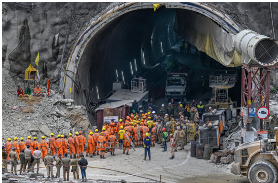
Le tunnel de Silkyara après l'extraction des 41 ouvriers Sajjad Hussain, Agence France-Presse
